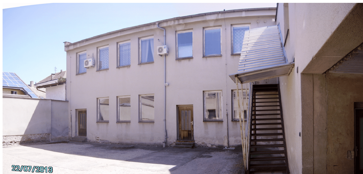
Budova na dvoře č.p. 684. Vpravo průjezd domem na p.p.č. 488/2 s ocelové schodiště do 1. patra
